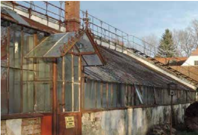
Das restaurierungsbedürftige Glashaus in Neudau, Foto: Murnig
