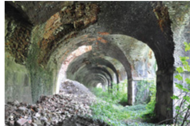
Abb. 8: Teilweise eingestürzte Gewölbe der Badgalerie, Zustand 2012
